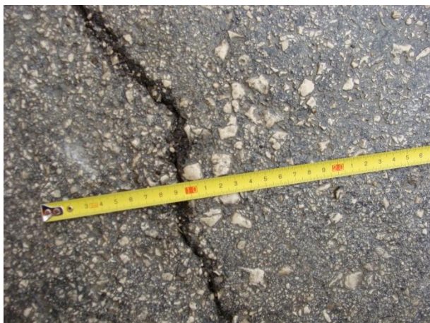
ρωγμή στο σημείο A18
