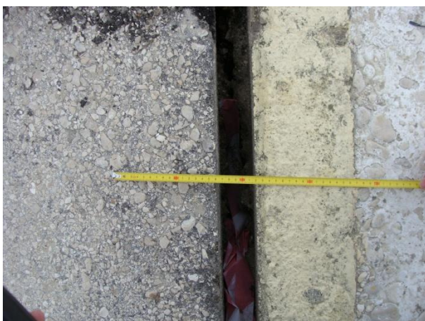
Σημείο F16 ρωγμή 2,5cm
