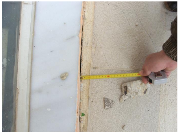
Σημείο B13 ρωγμή 0,1cm
