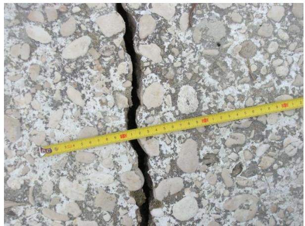
Σημείο E16 ρωγμή 1cm
