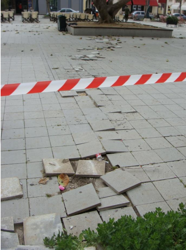
Σημείο A15 Ζημιές και ανοίγματα ρωγμών στην πλατεία του Ληξουρίου
