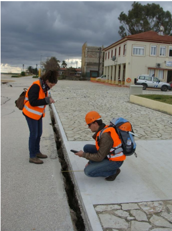
Σημείο I10 άνοιγμα ρωγμής 20cm
