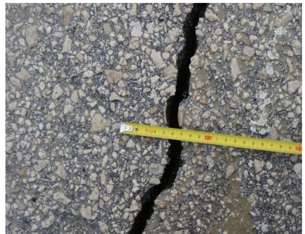
G17 άνοιγμα ρωγμής 3cm
