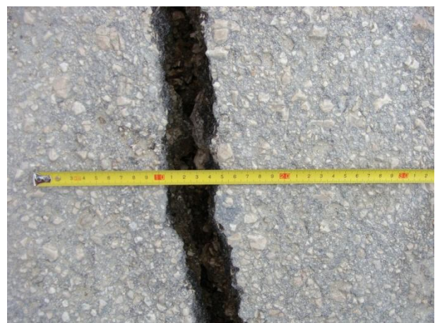
Σημείο G16 ρωγμή 1cm
