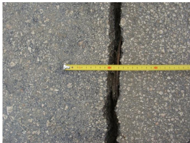
ρωγμή στο σημείο B18
