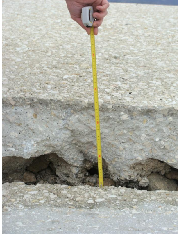
Σημείο G15 καθίζηση 25cm
