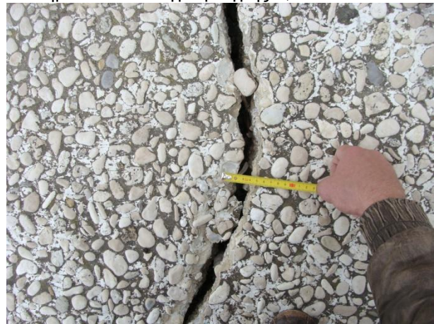
Σημείο D10 άνοιγμα ρωγμής 2cm
