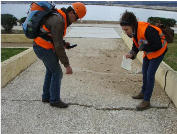
Σημείο E10 άνοιγμα ρωγμής 4cm
