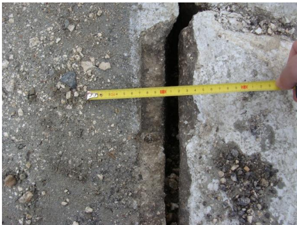
C17 άνοιγμα ρωγμής 3cm
