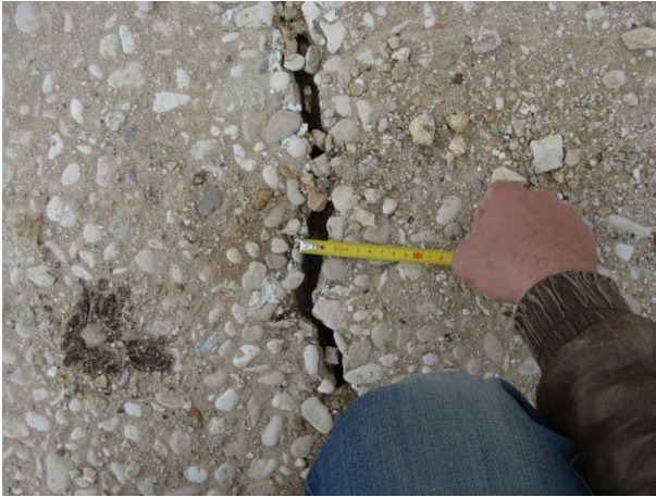
Σημείο G10 άνοιγμα ρωγμής 2cm
