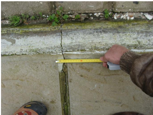
Σημείο A13 ρωγμή 0,1cm
