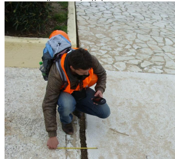
Σημείο F13 ρωγμή 6,5cm
