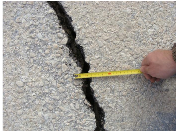
Σημείο B9 άνοιγμα ρωγμής 2,5cm
