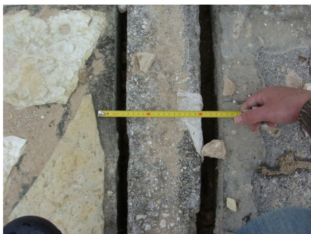
Σημείο H12 άνοιγμα ρωγμής 6cm
