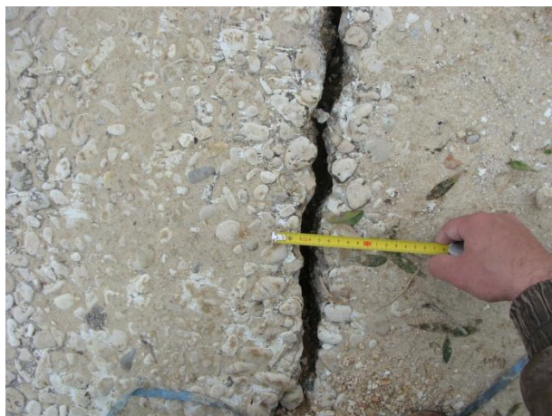
Σημείο E12 άνοιγμα ρωγμής 2cm
