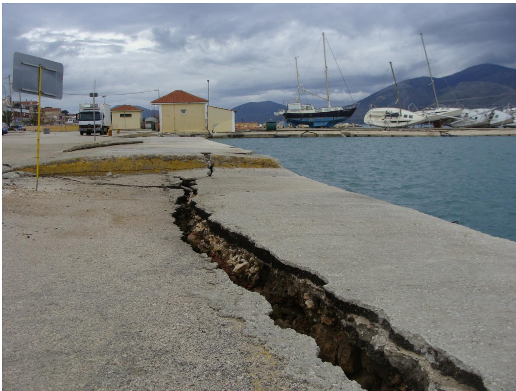
Η17. Άνοιγμα ρωγμής 35cm κοντά στον κρηπιδότοιχο, στο ελεύθερο μέτωπο λόγω πλευρικής εξάπλωσης. Παρατηρούμε ότι η ράμπα έδρασε σαν ελκυστήρας αποτρέποντας την μεγαλύτερη οριζόντια μετατόπιση.
