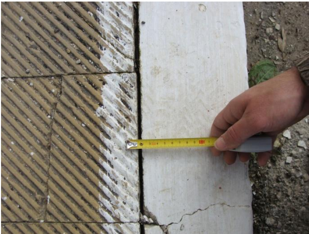
Σημείο A9 άνοιγμα ρωγμής 0,3 cm
