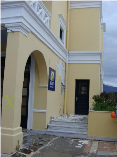
A17 ζημιές στο κτίριο ΚΕΠ
