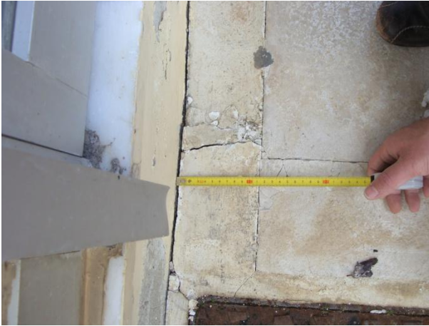
Σημείο A10 άνοιγμα ρωγμής 0,2cm
