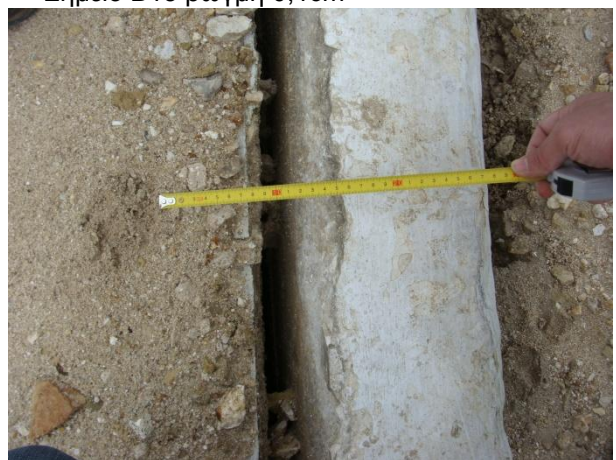
Σημείο D13 ρωγμή 3,5cm
