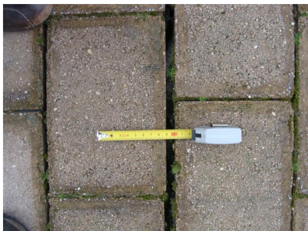
Σημείο A12 άνοιγμα ρωγμής 1cm
