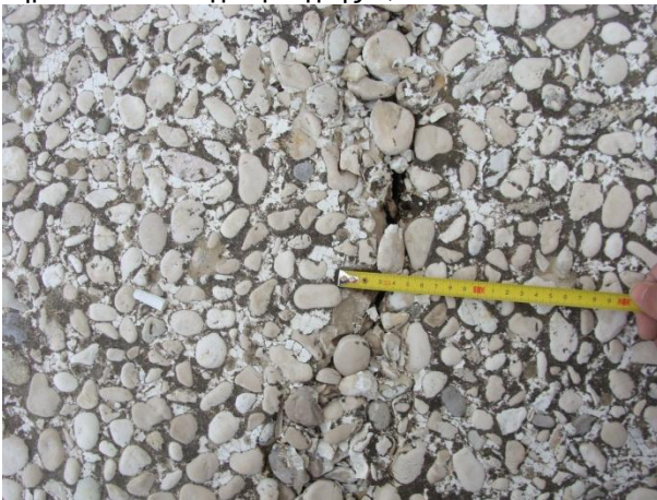
Σημείο C10 άνοιγμα ρωγμής 0,5cm
