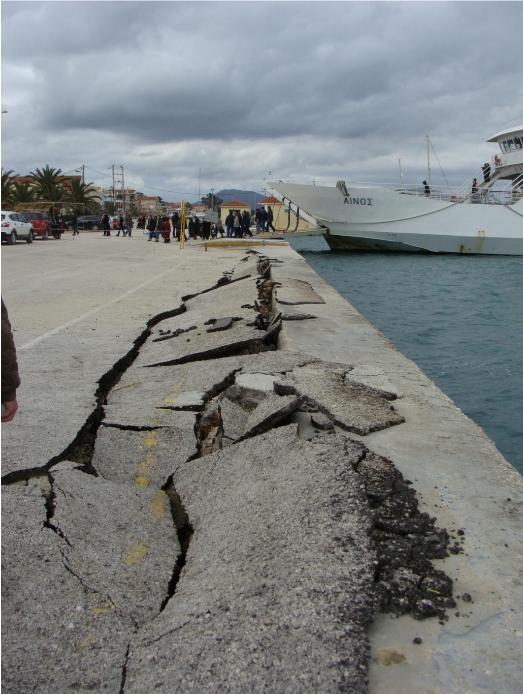
Σημείο H16 Σοβαρή ζημιά στον κρηπιδότοιχο. Ανατροπή, ολίσθηση και μετακίνηση του προς το ελεύθερο μέτωπο.
