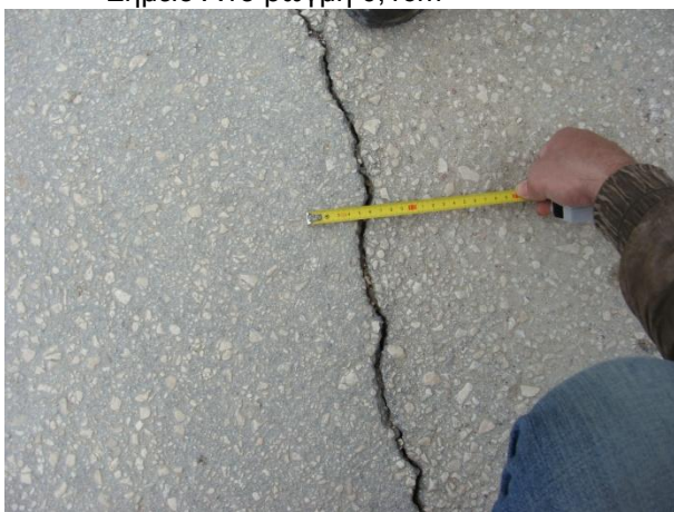
Σημείο C13 ρωγμή 1cm
