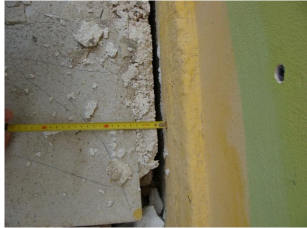
Σημείο B10 άνοιγμα ρωγμής 1,5cm
