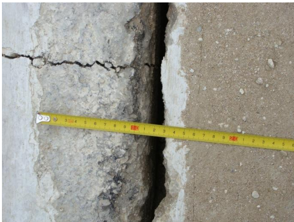
Σημείο D16 ρωγμή 2,5cm
