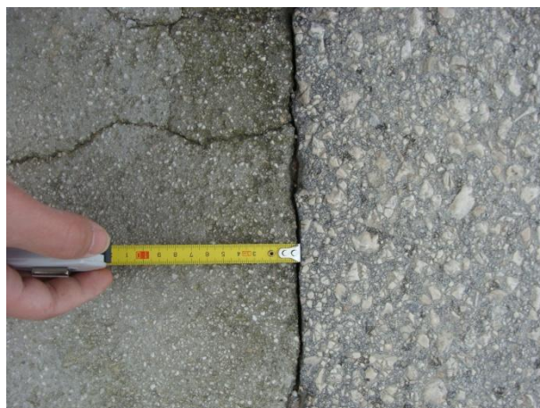
Σημείο C12 άνοιγμα ρωγμής 0,2cm
