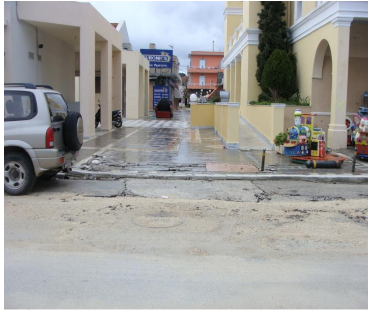
B17 άνοιγμα ρωγμών στην ασφαλτο και στον πεζόδρομο
