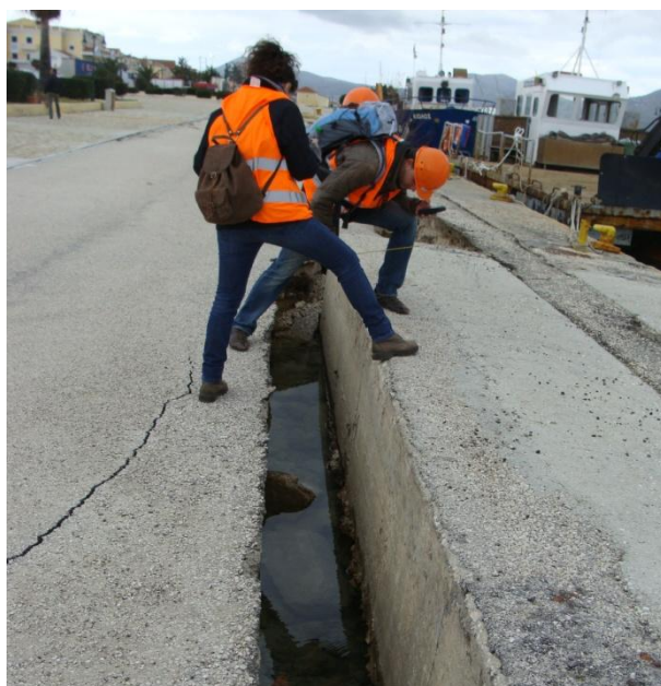
Σημείο J12 άνοιγμα ρωγμής 49cm.
